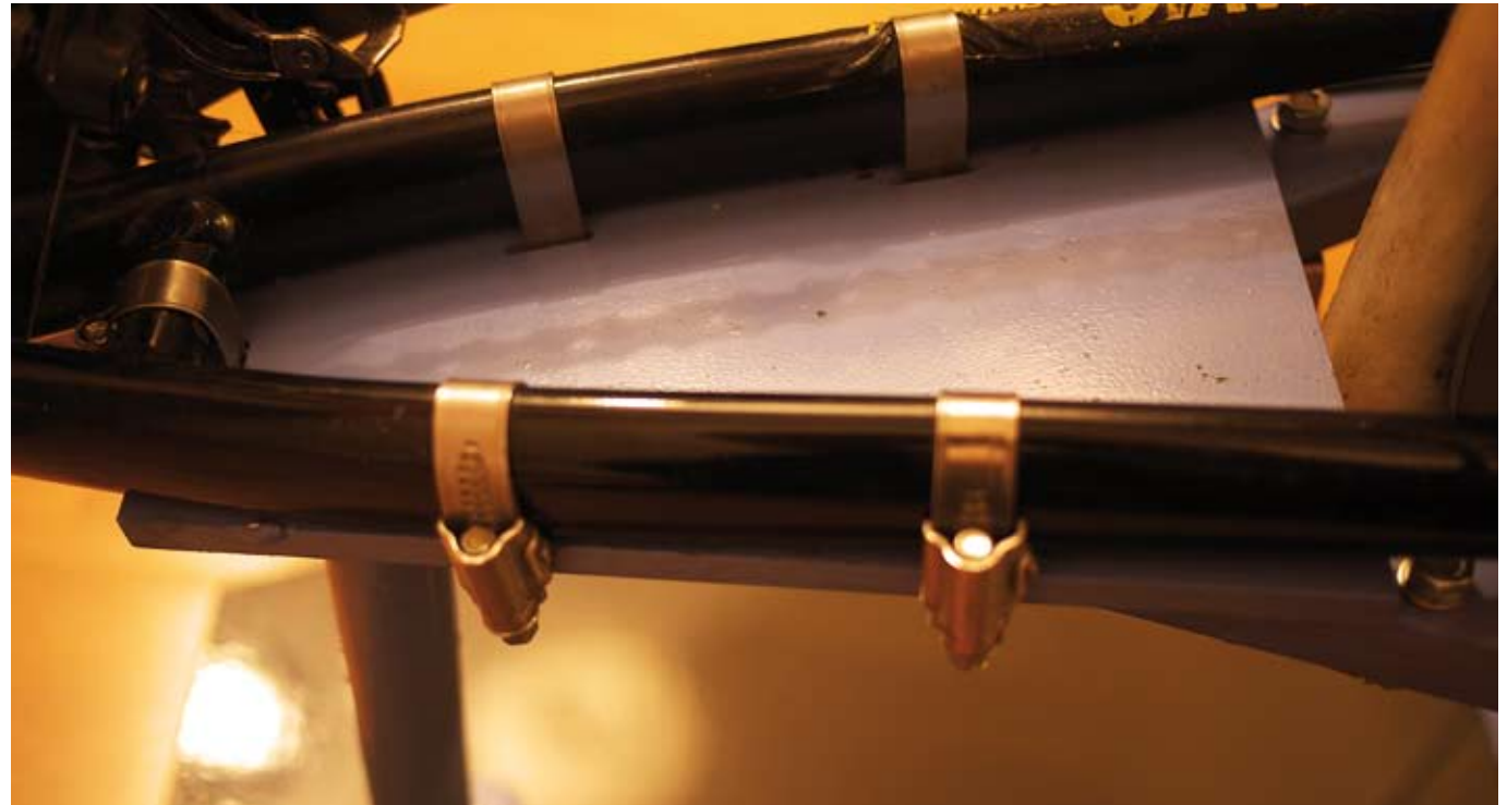
Abb. 17 : Stahlplatte mit 5 Briden
